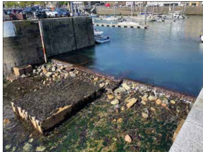
Die Sill hält bei Niedrigwasser einen definierten Wasserstand im Hafenbecken
